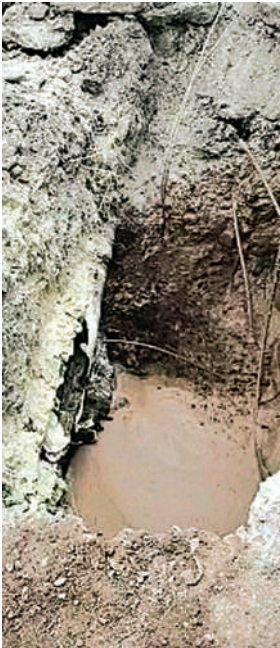
मेट्रो निर्माण कार्य के दौरान फूटी थिंक गैस की पाइप लाइन।
